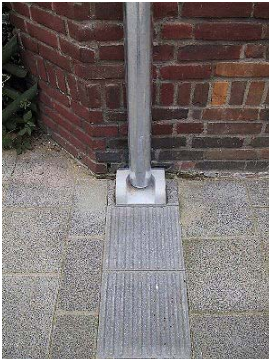
Figuur 8, regenwaterafvoer direct aan de straat met een 'afkoppelsteen'
